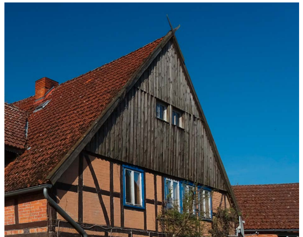
Fledermäuse benötigen für ihre Wochenstube größere Hohlräume zum Beispiel hinter Holzfassaden. Foto: Birgit Petersen
